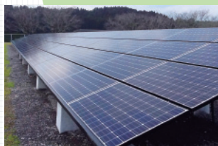
順調に稼働を続ける太陽光発電システム (デサントアパレル株式会社 西部工場)
